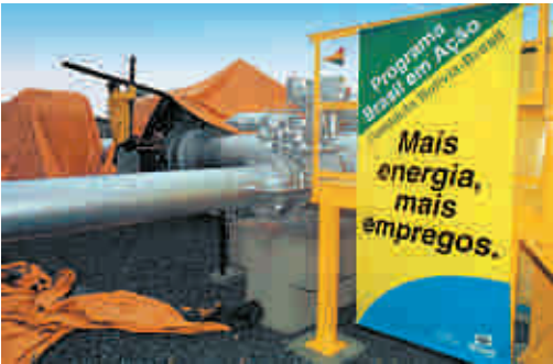
Trecho do gasoduto Brasil–Bolívia.
